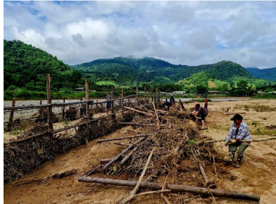
weggespoeld hekwerk moet worden opgeruimd en hersteld
